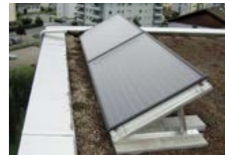
Flachkollektoren – auf Flachdach aufgeständert
