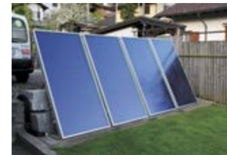
Flachkollektoren – im Freien aufgestellt
